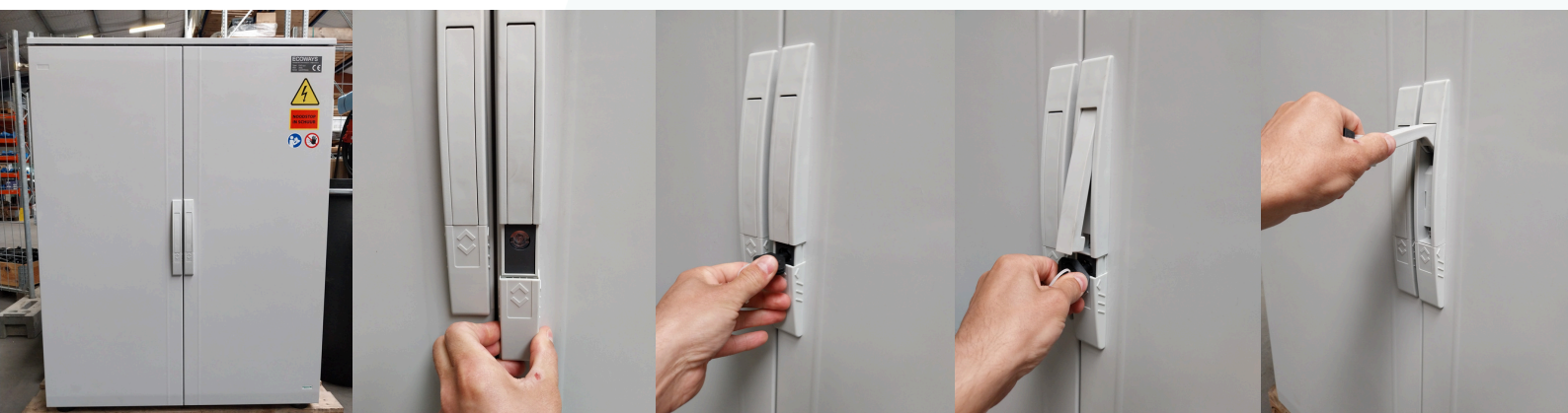
Abbildung 4 – Von links nach rechts: Öffnen des Schaltschranks
