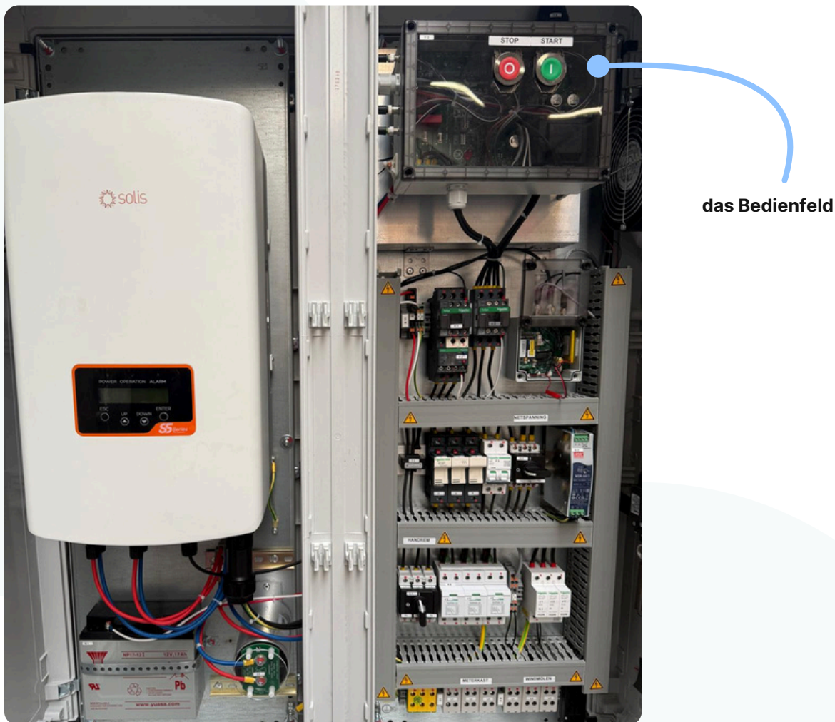
Abbildung 5 - Innenseite des Schaltschranks
