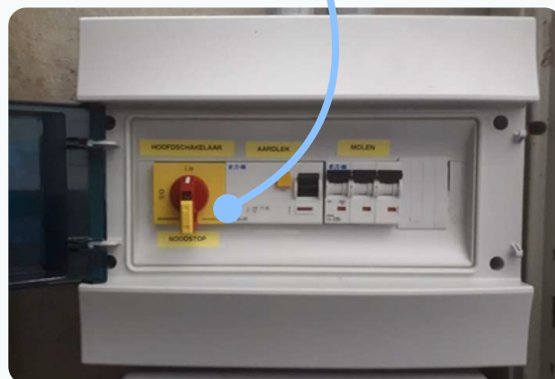
Abbildung 8 - Hauptschalter / Not-Aus-Schalter im Gebäude
