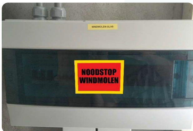
Abbildung 7 - Vorderansicht des Not-Aus-Schalters im Gebäude
