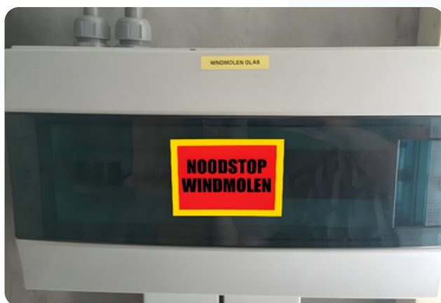
Figuur 7 – Vooraanzicht noodschakelaar in de schuur.
