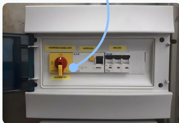
Figuur 8 – Hoofdschakelaar/noodschakelaar in de schuur.
