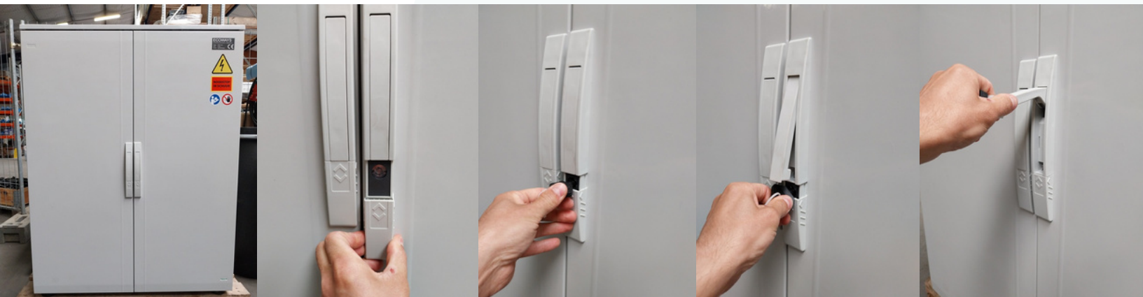
Figuur 4 – Van links naar rechts: het openen van de elektrakast.
