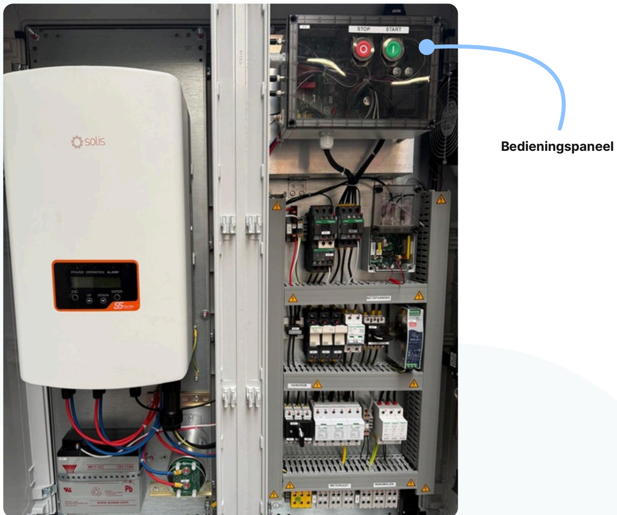
Figuur 5 - Binnenzijde van de elektrakast.
